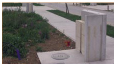
L'intégration des coffrets dans un petit muret construit à l'identique sur l'ensemble de l'opération permet d'en réduire l'impact.
